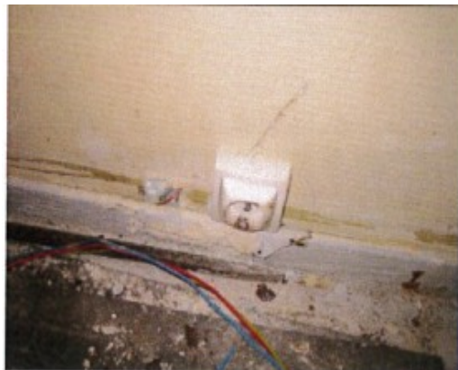
Fil électrique dénudé
